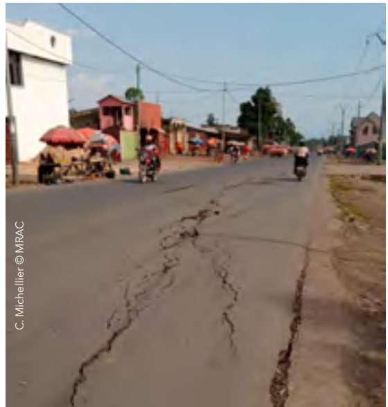
Fissures liées à l'intrusion du dyke (injection de magma).
